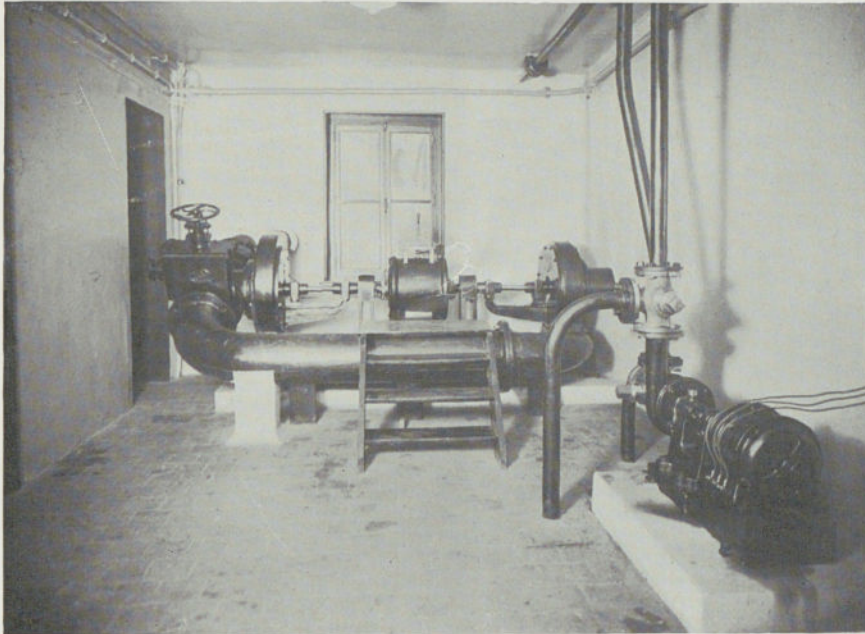
Ventilateur-compresseur à deux turbines.
