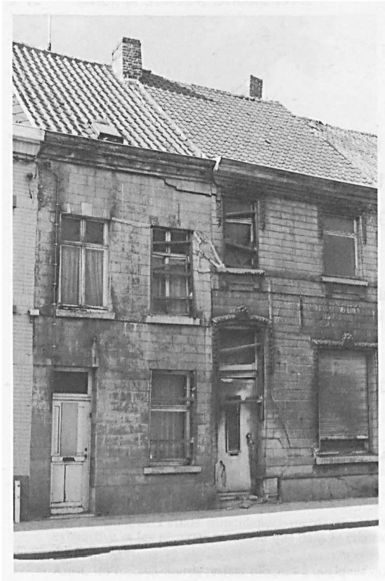
Fig 10. — Dégradation d'immeubles à Nimy (Mons).
