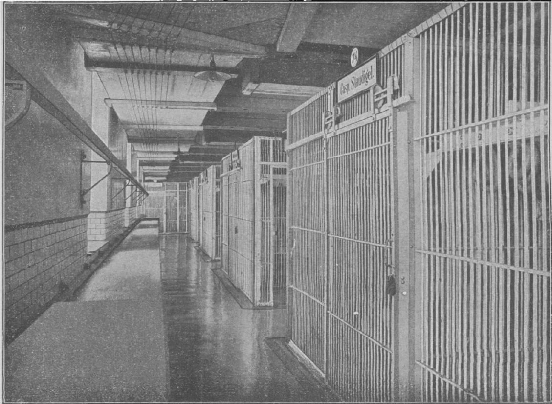
FIG. 353. — Chambre froide de l'abattoir de Cologne (Construction Humboldt à Kalk près Cologne). C. HUMBOLDT.
