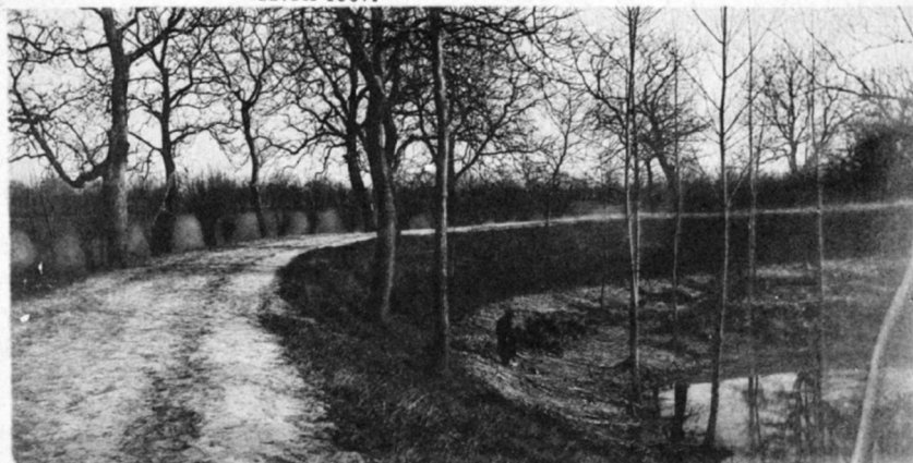
Phot. 67. Digue du polder de Hamme (en face de Thielrode), après rupture de la digue, à Drijgoten. Le polder est encore inondé. — Avril 1908.
