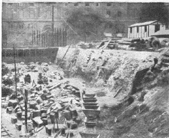
LE MUR DE LUTÈCE. — Les travaux d'excavation exécutés au marché aux fleurs pour la construction du métropolitain ont fait retrouver la première enceinte de Paris. Cette muraille a été édifiée, croient les archéologues, vers le milieu du IV e siècle. On prévoit de nouvelles découvertes aussi intéressantes.
