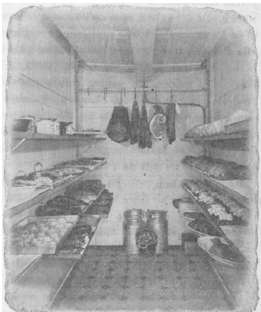
Fig. 5. — Intérieur d'une chambre froide servant de garde-manger à un restaurant (Installation Borsig).
