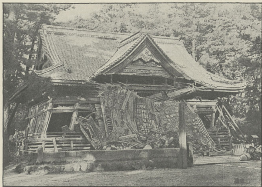
FIG. 199. — TEMPLE JAPONAIS DE SAKATA, GAUCHI PAR LE TREMBLEMENT DE TERRE DU SHŌNAI DU 22 OCTOBRE 1894 (d'après DAIROKU KIKUCHI).
