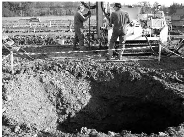
Fig. 5. — Vue de l'effondrement d'avril 2004.
