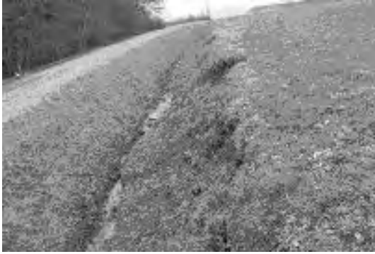
Fig. 10. — Rupture de la continuité hydraulique dans un fossé. Fig. 10. — Interruption of the hydraulic continuity in a ditch.
