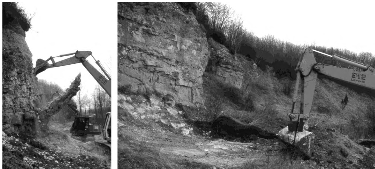
Fig. 3. — Travaux de restauration et de sécurisation des fronts de taille engagés par le Conservatoire d'espaces naturels du Nord et du Pas-de-Calais en 2000 (photos : CEN, 2000). La purge des éperons les plus dangereux (photo de gauche) a mobilisé les matériaux nécessaires au terrassement de la zone d'accueil (photo de droite) et du promontoire donnant accès pour le public à une partie de la coupe géologique.
