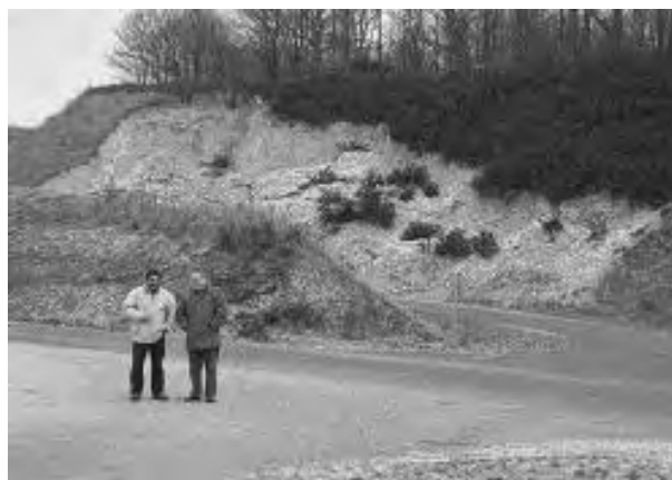
Fig. 7. — Vue du glissement de la VC5.
